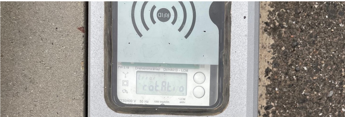
Abb. 52: Drehfeld falsch – Anzeige des Energiezählers
